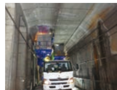
コンクリート構造物中性化対策工事 (万騎が原トンネル:土木関係) 発注者:相模鉄道(株)
