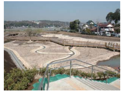
綾瀬浄水場公園整備工事 発注者:神奈川県内広域水道企業団
