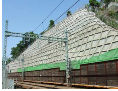
井土ヶ谷駅~弘明寺駅間 上下線吹付法面防護工事 発注者:京浜急行電鉄(株)
