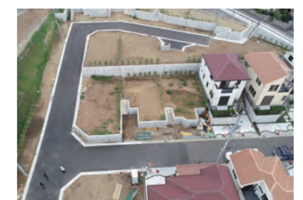
「(仮称)横浜西谷プロジェクト」第4期宅地造成工事 発注者:相鉄不動産(株)・ 京急不動産(株)・安田不動産(株)
