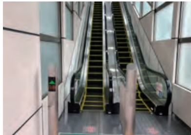
エスカレーター更新その他工事 (砂川7番駅西側連絡通路) 発注者:多摩都市モノレール(株)
