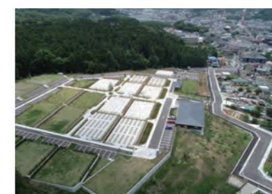
公園墓地川井聖苑計画造成工事 発注者:公益財団法人神奈川霊園
