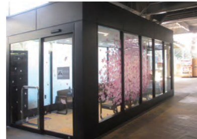
ホーム待合室新設工事 (弥生台駅・建築関係) 発注者:相模鉄道(株)
